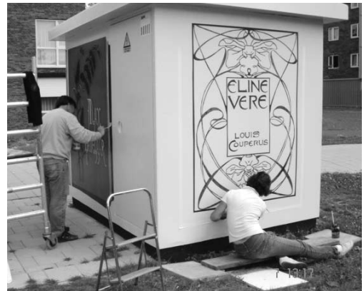
Het literaire transformatorhuis in Hoogvliet
